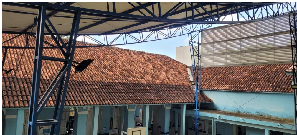
Foto 3: Ex. do local de retirada de telha cerâmica e engradamento de madeira.
