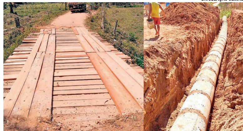
Além das pontes, a equipe da Secretaria também continua realizando a construção de redes de manilhas.
